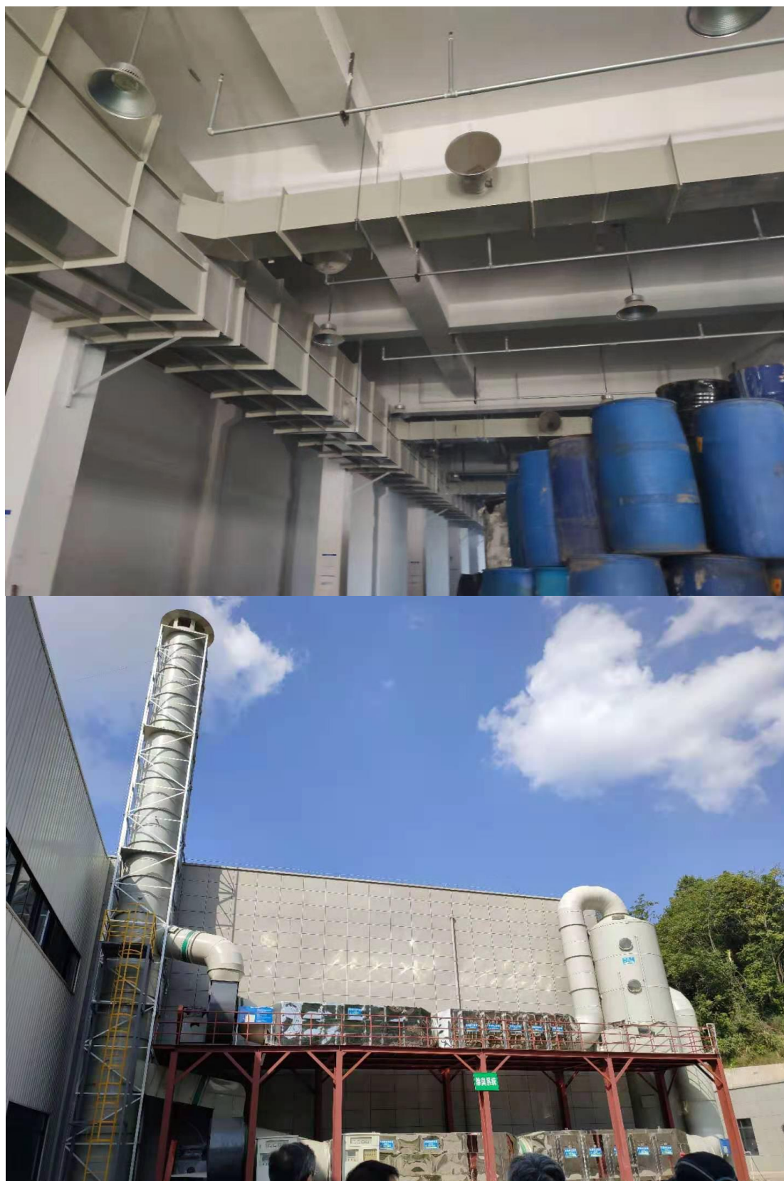
图 4-2 企业废气收集、处理装置
